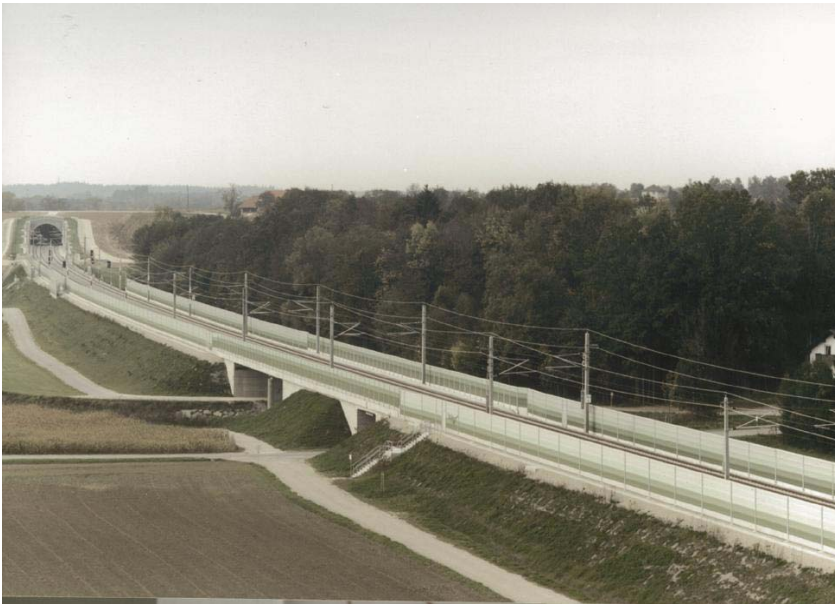
Bild 1: Schallschutzwand an einer Hochgeschwindigkeitsstrecke der Bahn
